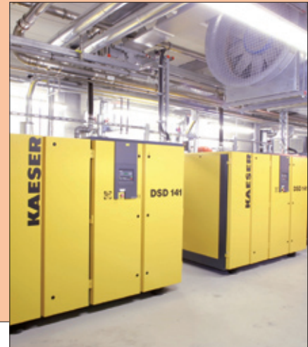
38 Prozent Druckluftkosten spart ein Produktionswerk in Süddeutschland unter anderem mit Hilfe dieser optimierten Kompressorstation gegenüber der früheren Versorgung ein.
