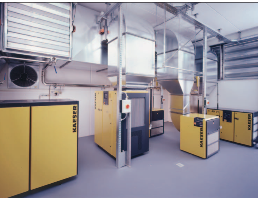
Abb. 1: Moderne Druckluftstation in einem mittelständischen Industriebetrieb mit Kältetrockner (links) und übergeordneter Steuerung auf Industrie-PC-Basis.
