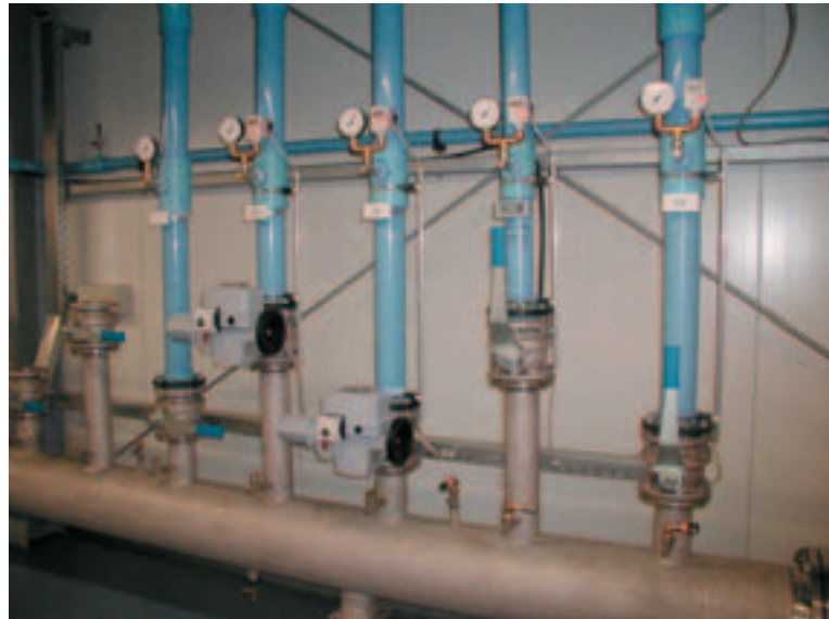
Bild 2: Ein Sammler führt die getrocknete Druckluft einer Verteilerstation zu, welche die einzelnen Werkhallen versorgt.
