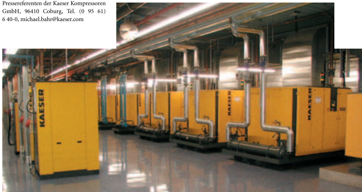
Bild 1: Die neue Druckluftzentrale im ISE-Werk Bergneustadt. Sieben Schraubenkompressoren Kaeser DSD 241 (rechts) erzeugen die benötigte Druckluft ebenso effizient wie zuverlässig.
