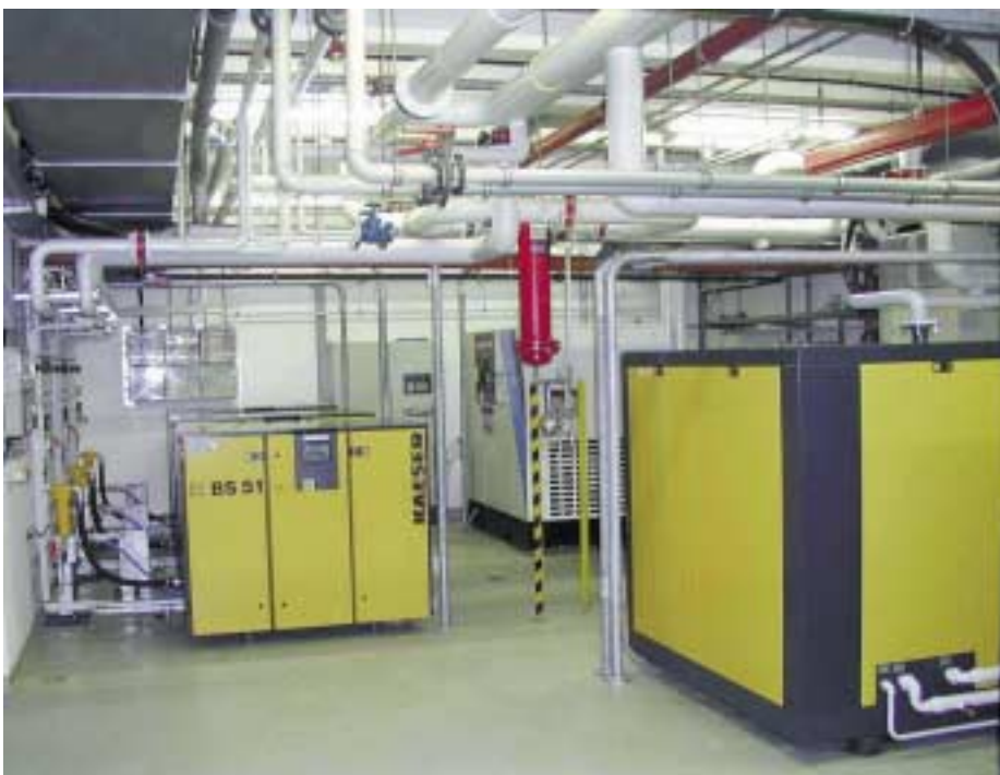
4: Blick in die modernisierte Kompressorstation (hier die Station 3) im Hilti-Werk Kaufering
