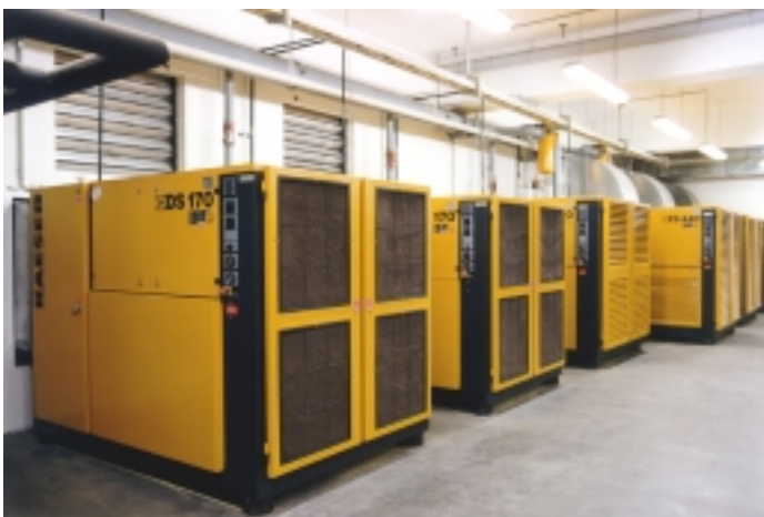
Sieben größere Schraubenkompressoren der Baureihen Kaeser FS, ES und DS soeisen ein 5-bar-Netz mit der erforderlichen Arbeitsluft.
