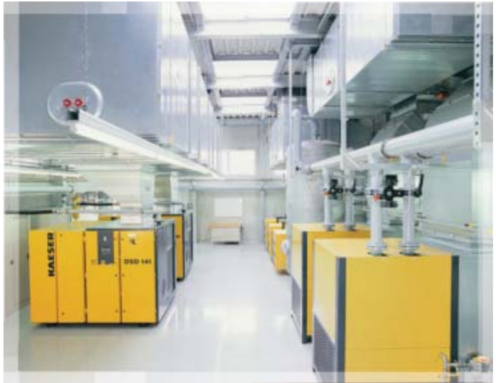
Druckluftstation in einem Automobilwerk. Der Betreiber spart dank umfassender Optimierung seiner Druckluftversorgung jährlich rund 70.000 Euro an Energiekosten ein.
